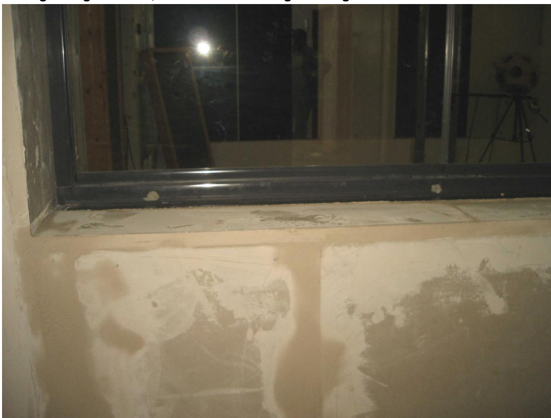
Bild 8: Balkonverglasung Lumon 5, Detail Entwässerungsöffnungen verschlossen
